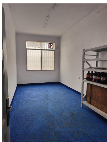
危废暂存间(固态)
